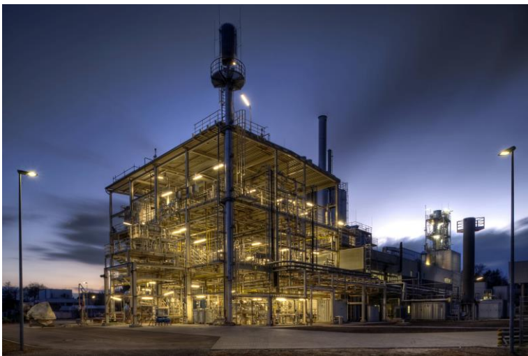
An der Karlsruher Pilotanlage bioliq wird erforscht, wie aus Biomasse hochwertige Kraftstoffe erzeugt werden können. (Bild: KIT)
